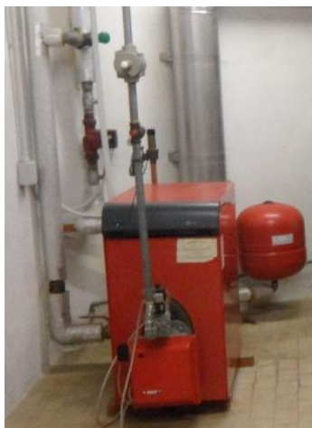
Figura 4.10 - Particolare della caldaia
