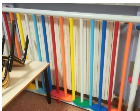
Figura 4.6 - Particolare dei terminali di emissione
