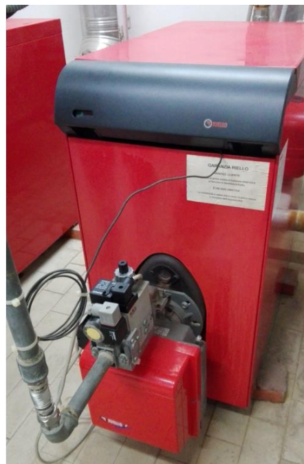
Figura 4.11 - Particolare caldaia produzione ACS
