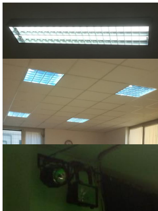
Figura 4.13 - Particolare dei corpi illuminanti
